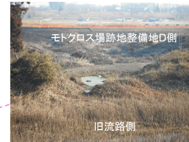
モトクロス場跡地整備地D側 旧流路側 2015秋の台風による出水で旧流路河岸の一部が崩壊し当整備地と接続した。
