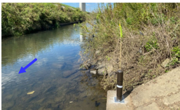
図-3 低水護岸へのセンサー設置状況
