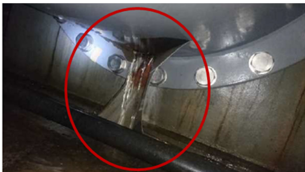
写真-3 長良川河口堰での漏水状況 1)
