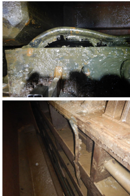
写真-2 水密ゴム破損状況
