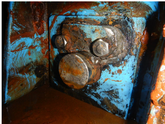
写真－3 扉体吊金物腐食・欠損状況
