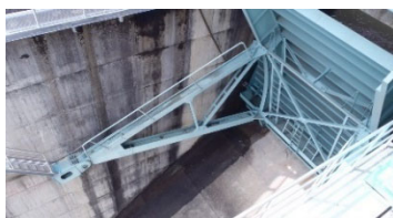
写真-3 漏水状況
