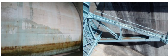
写真-2 扉体、脚柱部の発錆状況
