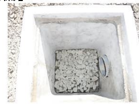
雨水貯留浸透枡整備事例（昭和町）
