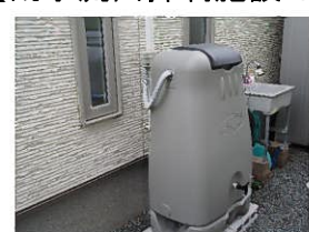
貯留槽の整備事例（富士市）
