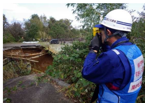
写真：令和元年東日本台風等 千葉県佐倉市の被災状況調査 （関東地方整備局提供）
