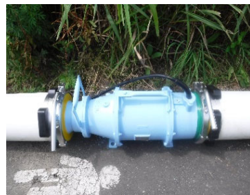
中継ポンプ(陸上設置)
