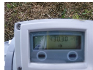
流量計表示(430m 3 /h(7.2m 3 /分)) ※7.5m 3 /分のポンプ1台使用
