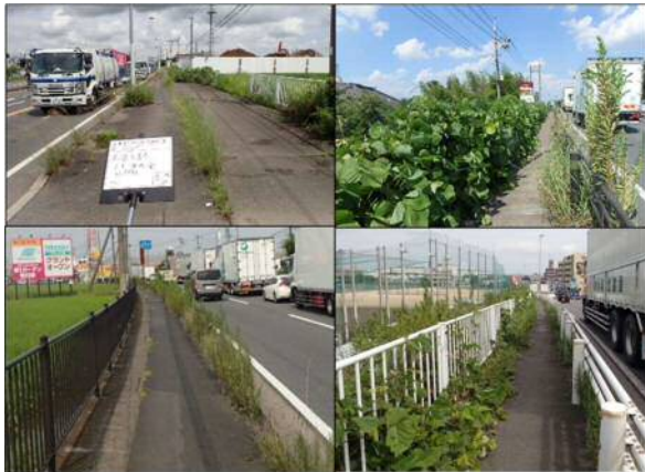
図-4 歩道の雑草繁茂状況
