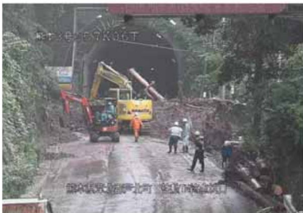
国道3号 佐敷トンネル付近の道路啓開 （熊本県芦北町）
