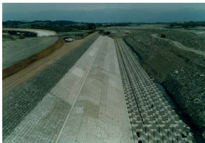
写真-2.2.2 洗掘防止対策の例（韮崎市韮崎千本柳地先：釜無川）
