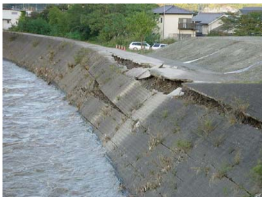
写真-1.2.6 護岸が崩落した状況
