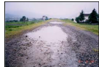
<堤防天端不陸>
