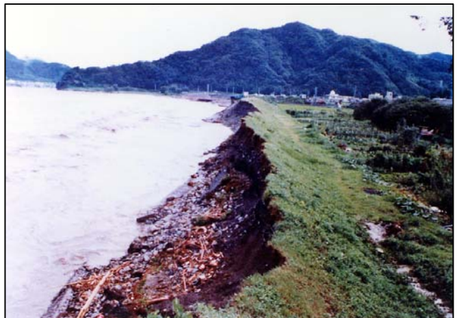
写真－1.2.21 堤防洗掘状況 ＜昭和57年8月 身延町波木井地先＞
