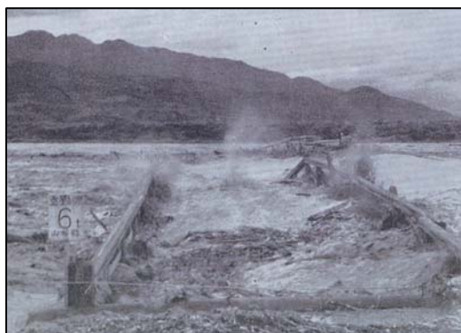
三郡東橋の流出
