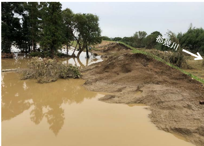
2019.10.14 12時00分時点 被災状況
