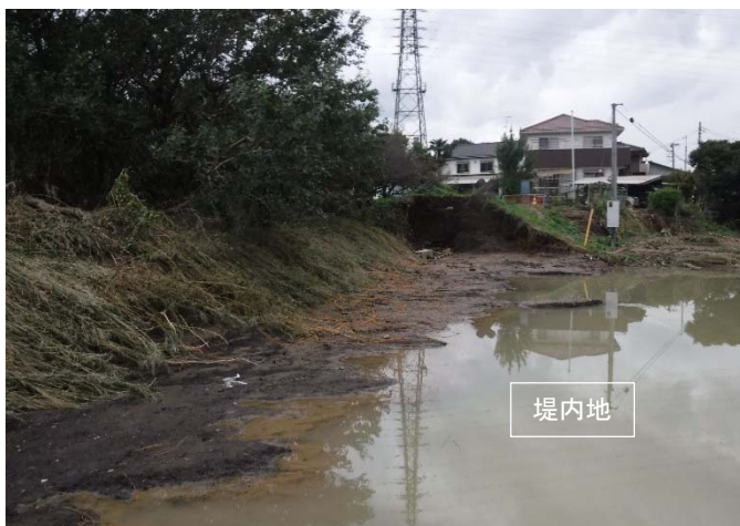
2019.10.15 15時00分時点 被災状況
