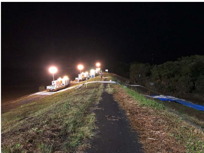
排水ポンプ車・照明車稼働状況 10月14日午後
