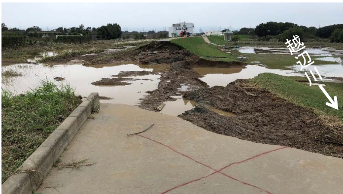
2019.10.14 9時20分時点 被災状況
