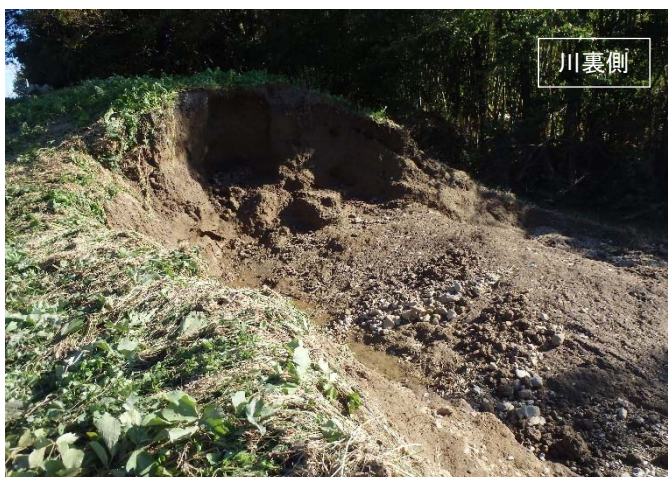
2019.10.13 15時00分時点 被災状況
