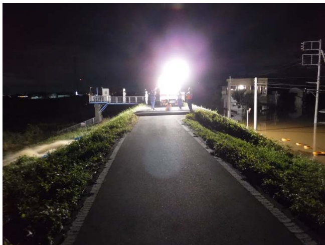
排水ポンプ車・照明車稼働状況 10月13日午後
