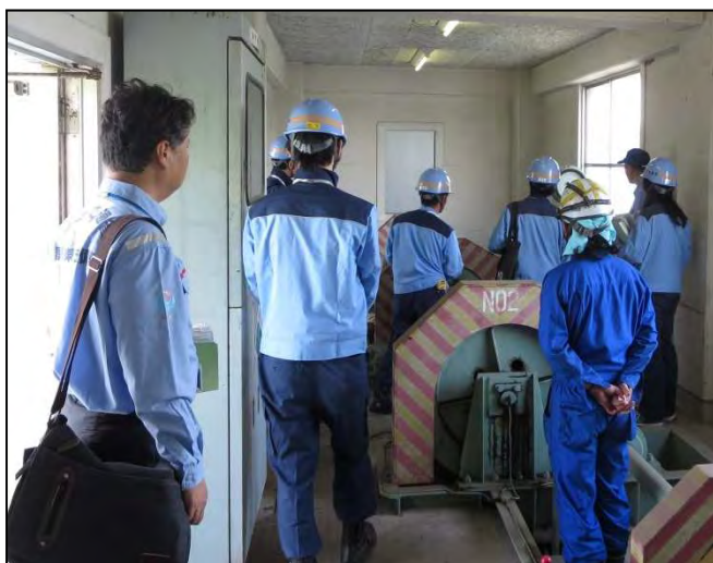
樋管の動作確認
