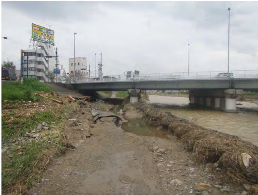
②③ 浅川 11.4k 右岸 (東京都八王子市) 河岸侵食 L=123m
