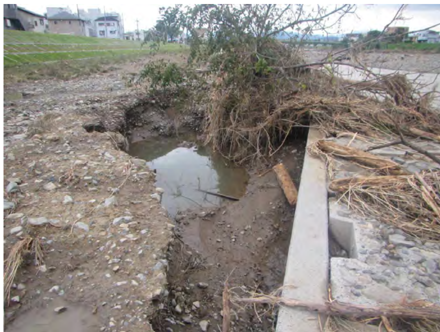
②④ 浅川 11.8k 右岸 (東京都八王子市) 河岸(高水敷)洗掘 L=26m
