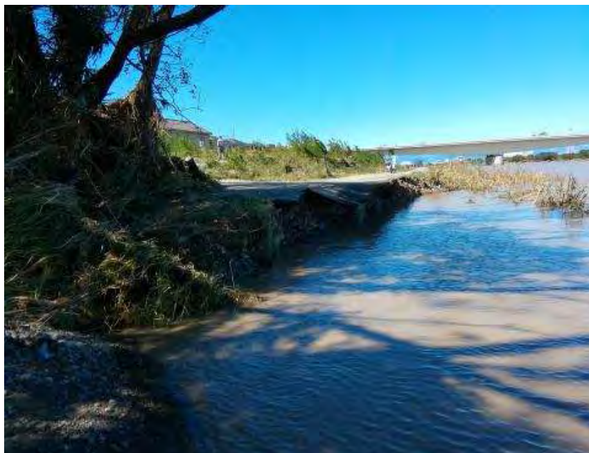
⑬多摩川 29. 2k 右岸（東京都稲城市） 河岸侵食 L=140m
