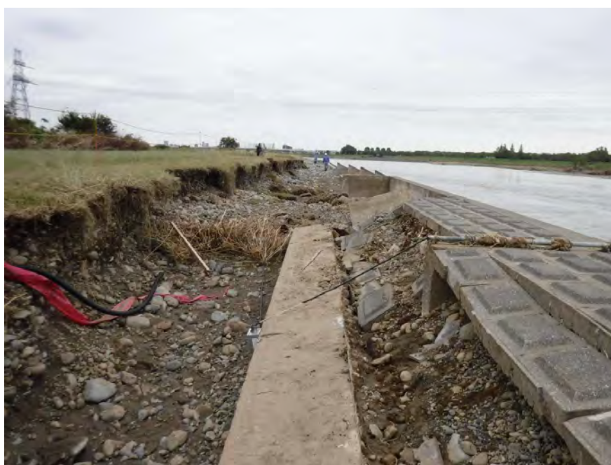
⑭多摩川 30. 6k 左岸（東京都府中市） 低水護岸崩壊 L=120m
