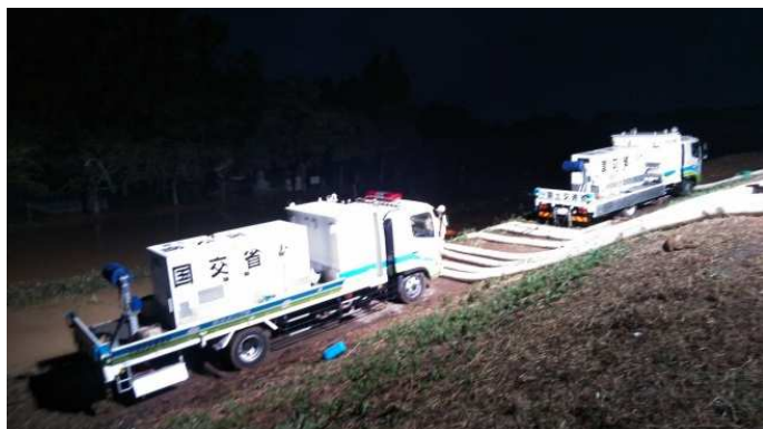
排水ポンプ車設置状況 10月14日午後
