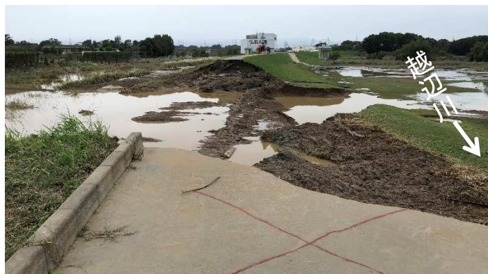
2019.10.14 9時20分時点 被災状況
