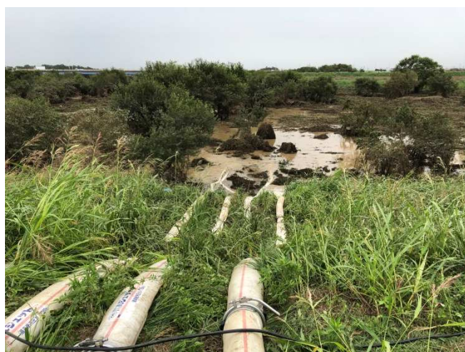
排水状況（川表（小畔川）） 10月14日午前
