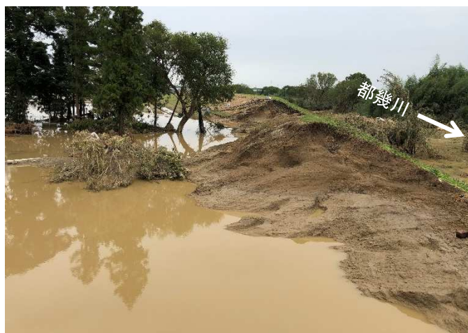
2019.10.14 12時00分時点 被災状況
