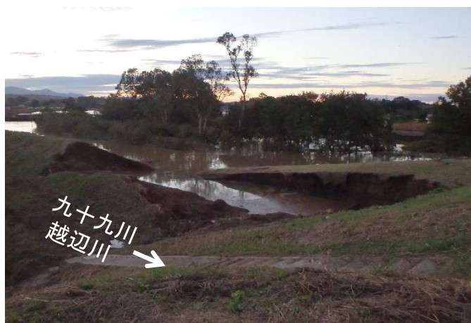
2019.10.13 17時30分時点 被災状況
