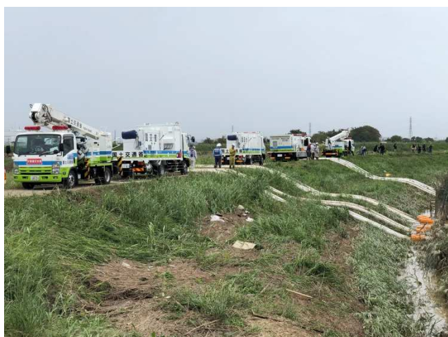
排水ポンプ車稼働状況 10月14日午前
