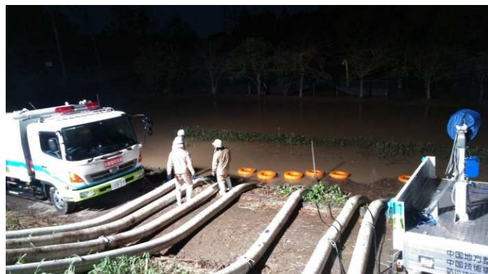
排水状況(川裏) 10月14日午後
