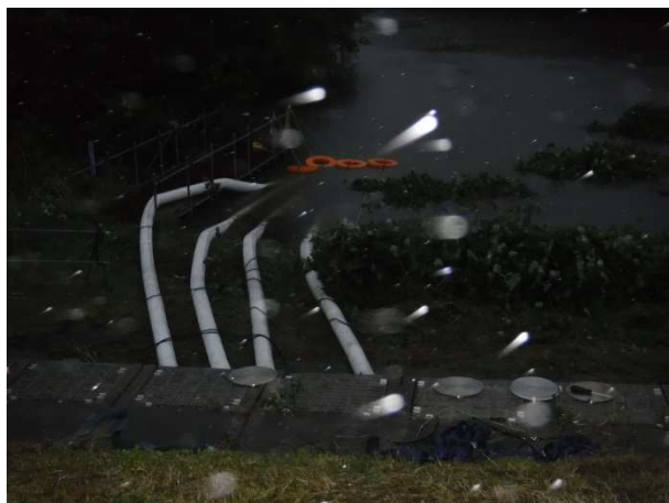
排水状況(川裏) 10月12日午後
