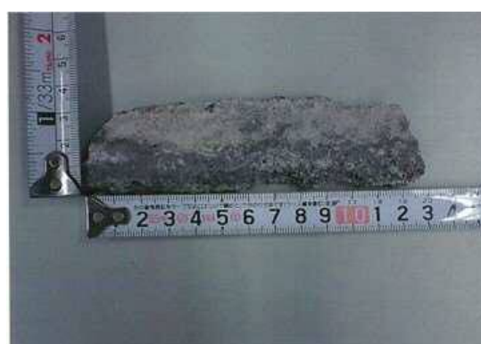
剥離・落下したコンクリート片(寸法)
