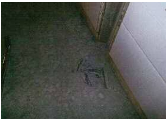
剥離・落下したコンクリート片
