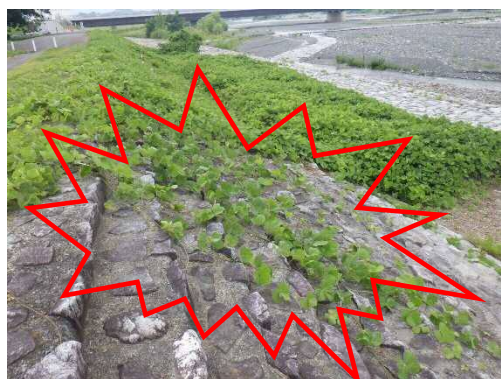
階段を葛が覆っている
