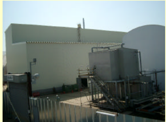
無害化処理設備の状況 (H16.3.28撮影)
