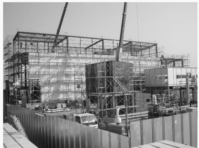
無害化処理設備の状況(H16. 2. 20撮影)
