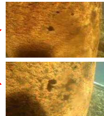
鋼管の腐食状況
