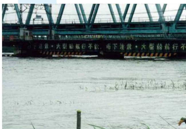
京成押上線橋梁に迫る洪水
