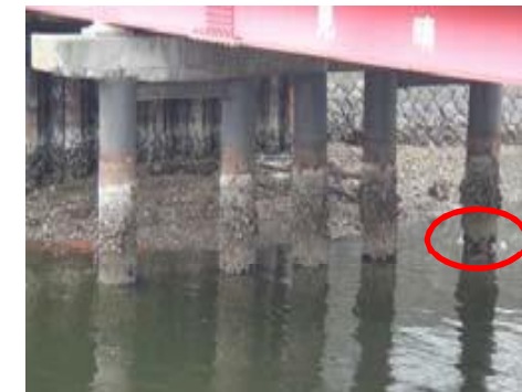
【重大な損傷の事例(橋梁)】
