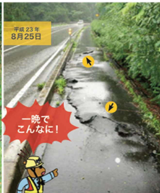
平成23年8月25日撮影 歩道のクラックと隆起
