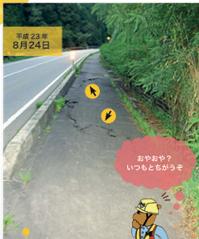
平成23年8月24日撮影 歩道のクラックと隆起
