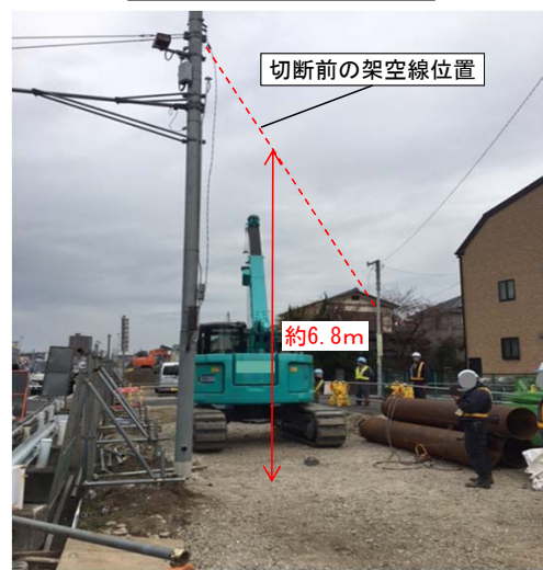
事故発生現場
