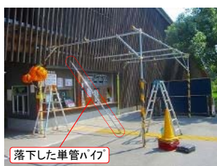
設置状況(事故直後)
