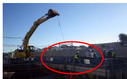
事故発生状況写真
