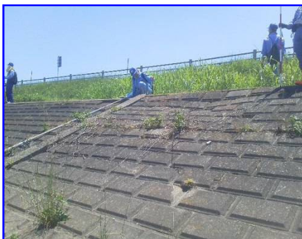
坂川左岸5.5k付近、川表護岸沈下(要監視)
