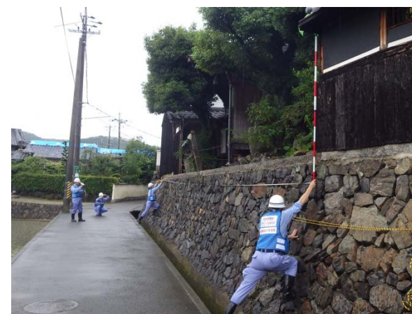
道路の被害状況調査
