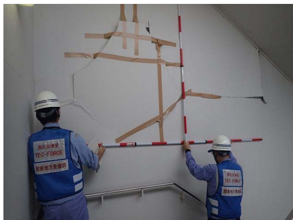
箕面市役所の被害状況調査
