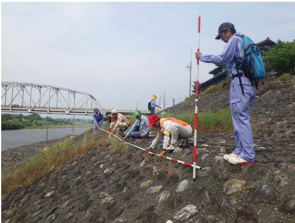
異常箇所を確認
