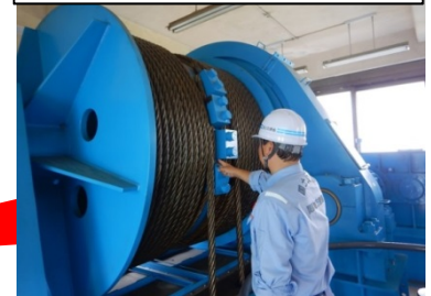
機械設備動作確認(岩淵水門)
