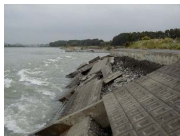
渡良瀬川の護岸被災状況（太田市）
