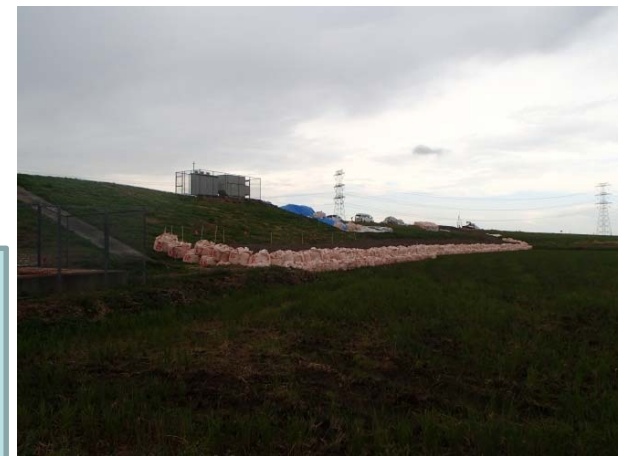
小貝川における堤内地の漏水
