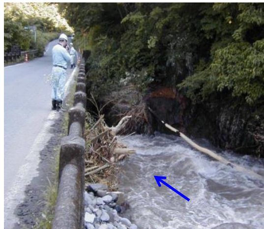
おぐろがわ ②小黑川橋の流木集積状況
