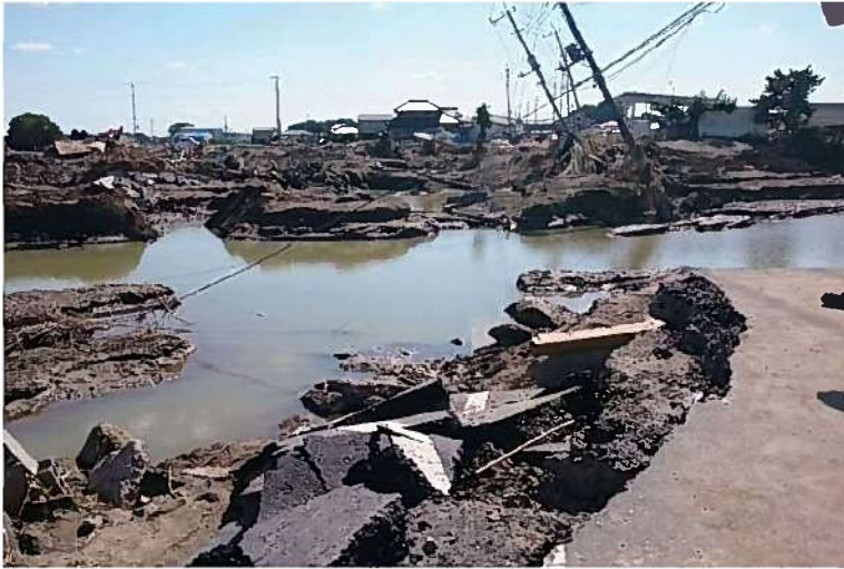
インフラの被災状況
