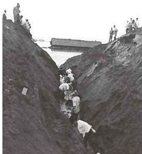
くさく ていぼう かつしかく 人力掘削による江戸川堤防の切り下げ(葛飾区)
