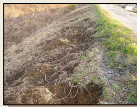
▲イノシシによる法面損傷状況
