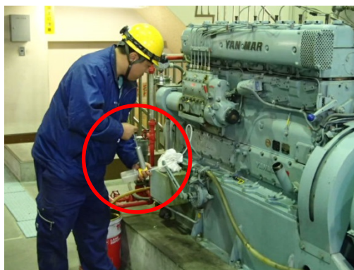
写真-1 オイルゲージ孔からのサンプリング
