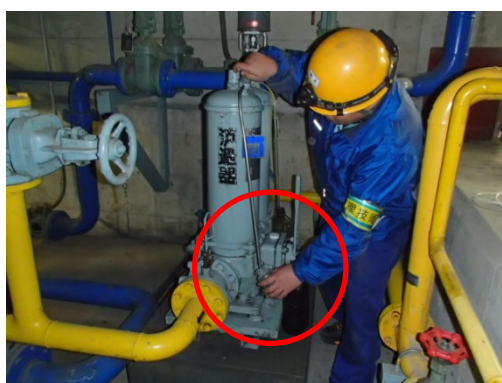
写真-3 オイルフィルター部からのサンプリング
