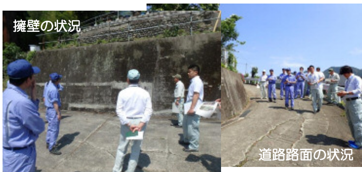
小規模な崩落箇所の状況確認調査 （譲原地すべり：藤岡市）
