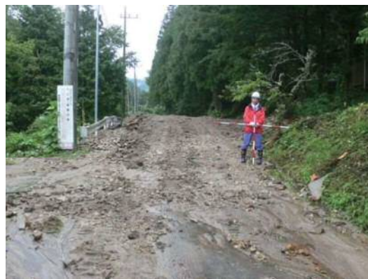
芹沢地区被災状況把握
