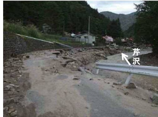
市道芹沢線の被害状況
