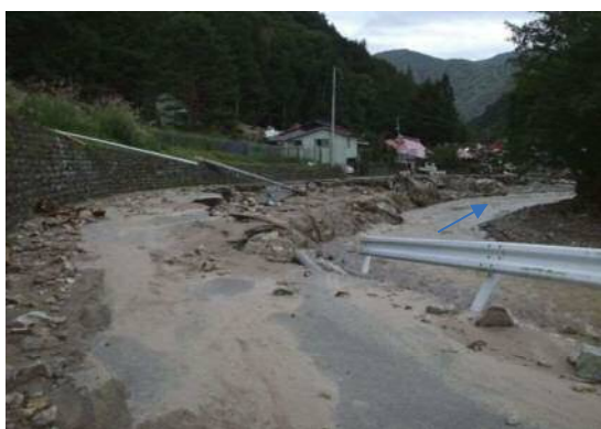
流失した市道芹沢線
