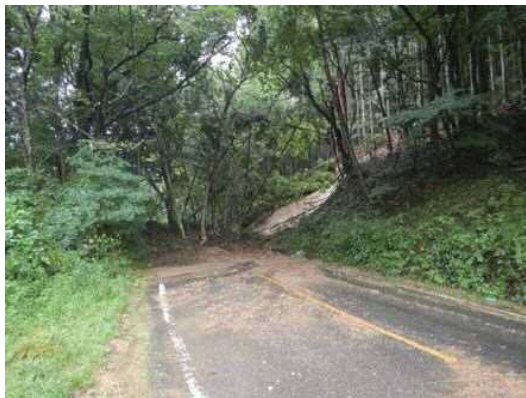
国道 121 号の状況 土砂流出
