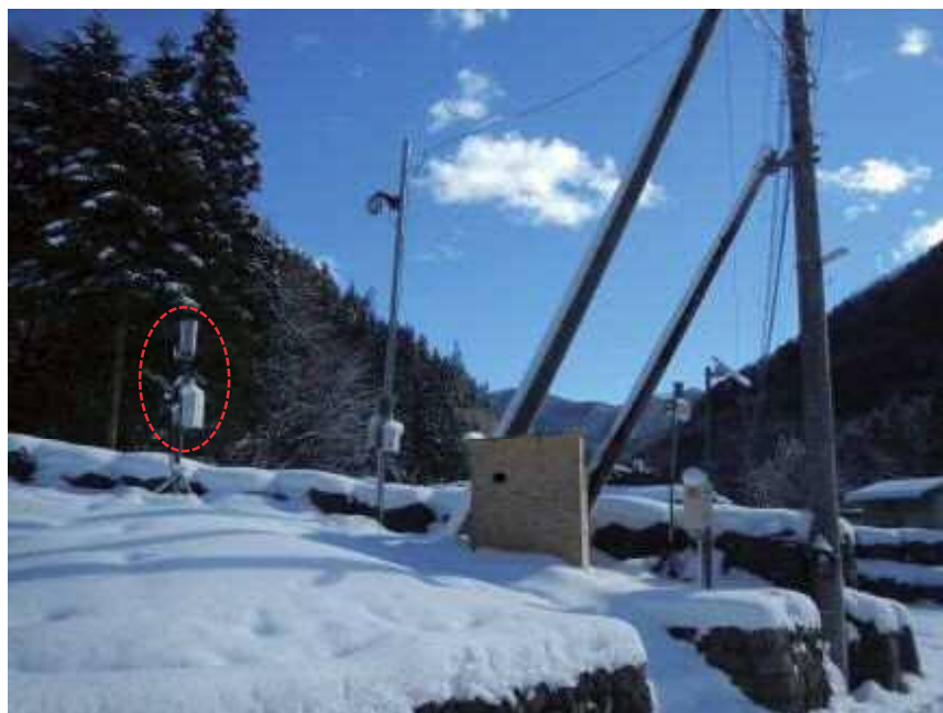
冬期に設置されたヒータ付雨量計と温度計
