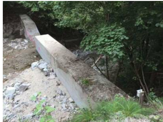
田茂沢砂防堰堤に設置された土石流センサ
