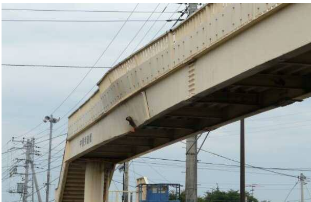
高さ違反により歩道橋に車両が接触 (国道139号 山梨県富士吉田市)
