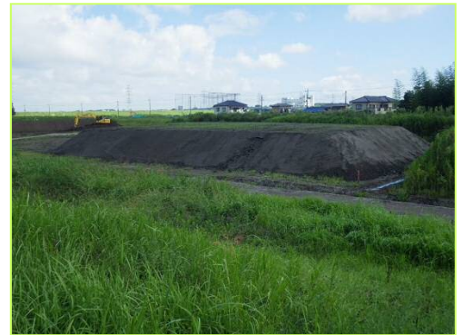
流山建設発生土トラック南地区、生産土量約3,300m 3 の仮置き状況
