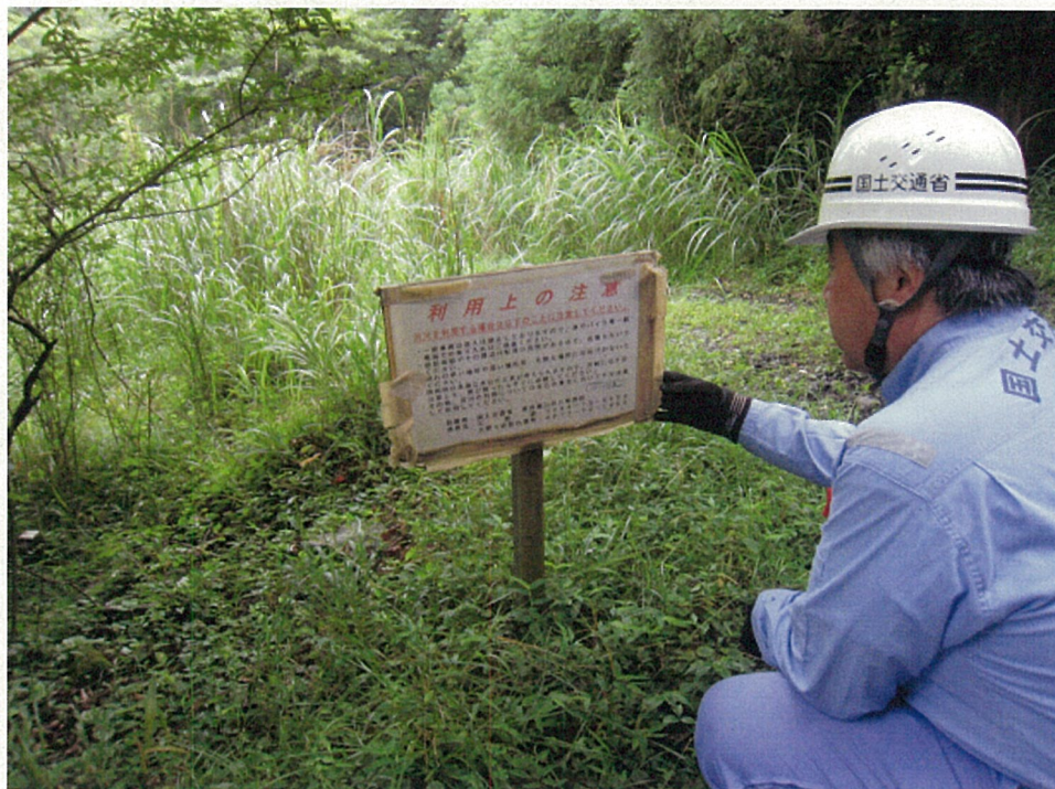
注意喚起看板の破損
