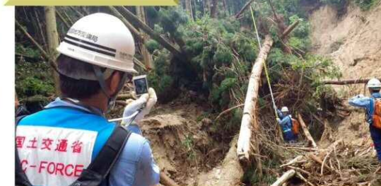
【H26.8 広島土砂災害】 (広島県広島市)
