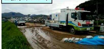
■排水ポンプ車
