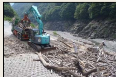
▲流木処理の状況
