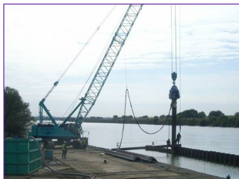
バイプロハンマによる矢板護岸工 の打設状況の様子:H27.11.13撮影
