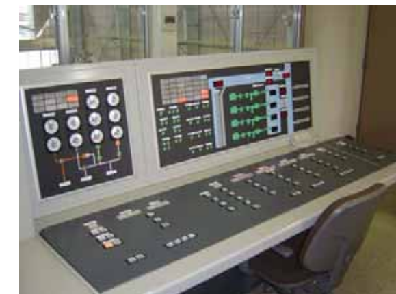
ゲート・ポンプの確実な操作
