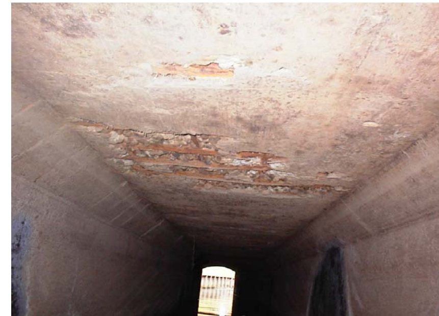
コンクリートが劣化し 鉄筋が露出した樋管の内部
