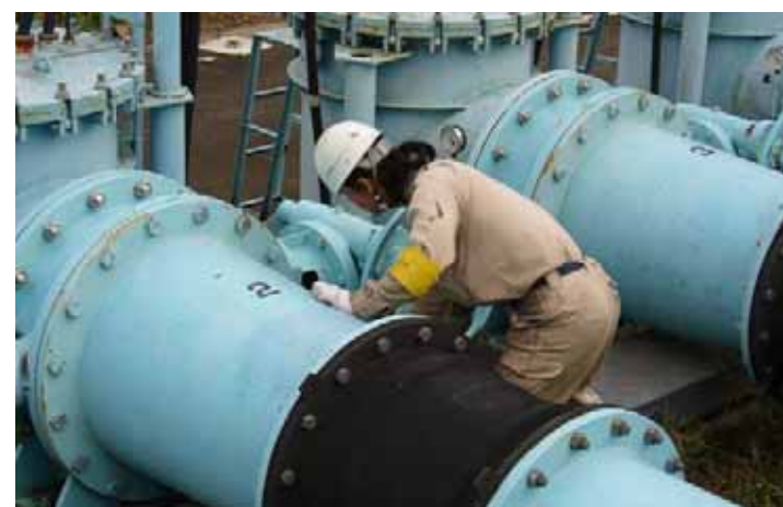
老朽化施設の増大 (施設点検状況)
