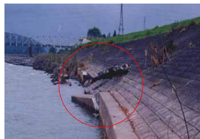
平成13年9月洪水 護岸の洗掘・崩壊 栃木県塩谷町上平地先
