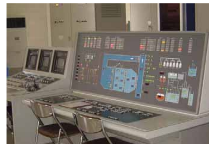
ゲート・ポンプの確実な操作
