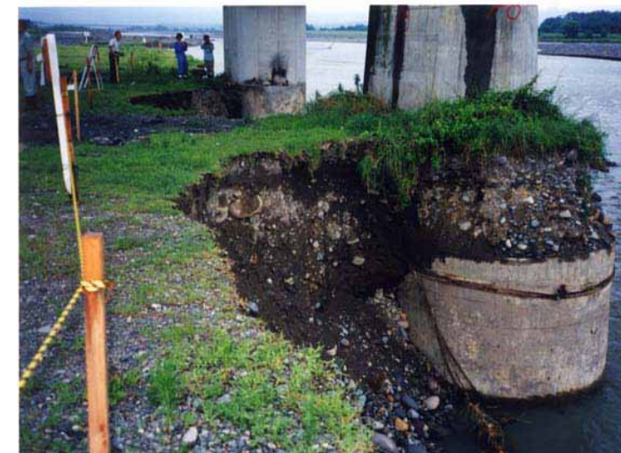
平成13年9月洪水 橋脚基礎の深掘れ状況 東北新幹線橋梁
