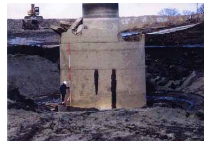
橋脚基礎の深掘れ状況 (平成12年) 石下大橋付近
