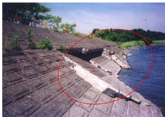
平成14年7月洪水 護岸の洗掘・崩壊 栃木県河内町白沢地先
