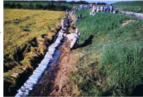
昭和 57 年 9 月洪水 漏水の状況 常総市樋ノ口地先
