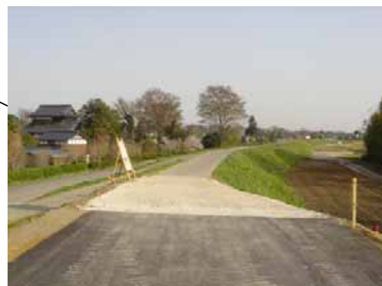
堤防の高さ及び断面が不足 つくばみらい市小絹地先
