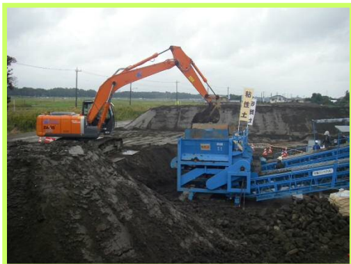
バックホウが建設発生土を万能土質改良機に投入する作業イメージ
