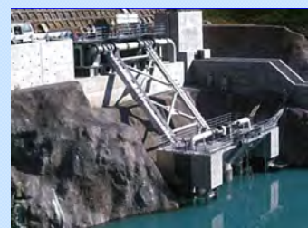
フロート型取水設備
