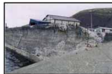
老朽化した海岸堤防
