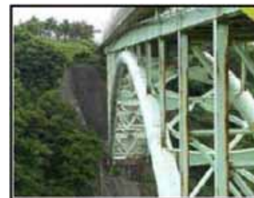
アーチ橋の腐食状況
