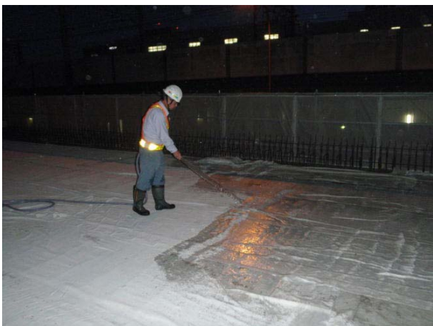
（散水により表面の乾燥防止中※） ※ひび割れの発生を抑えます。
