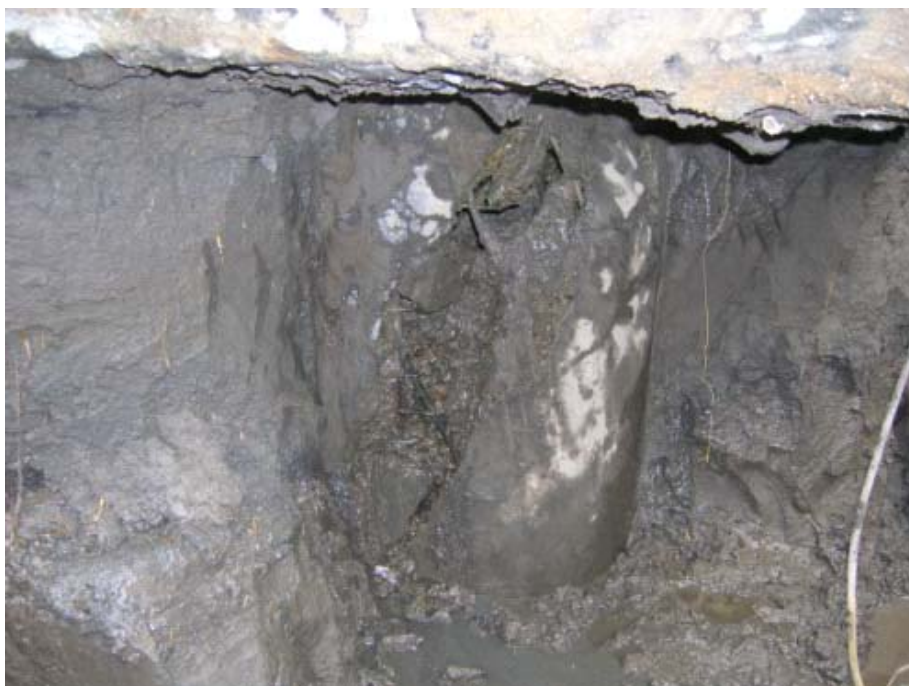
写真－29 基礎杭頭部の破断
