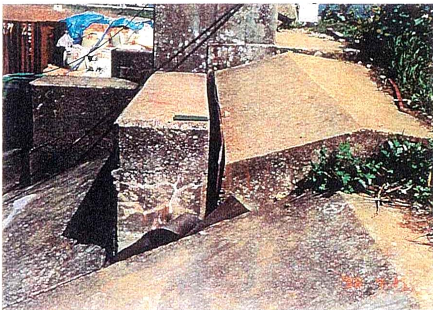
写真-2 胸壁部の抜け上がり、胸壁に接する護岸および 天端肩コンクリートが最大 40cm 沈下している。
