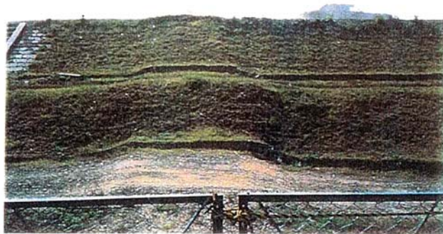
図 2.12 天端及び法面の抜け上がりの例
