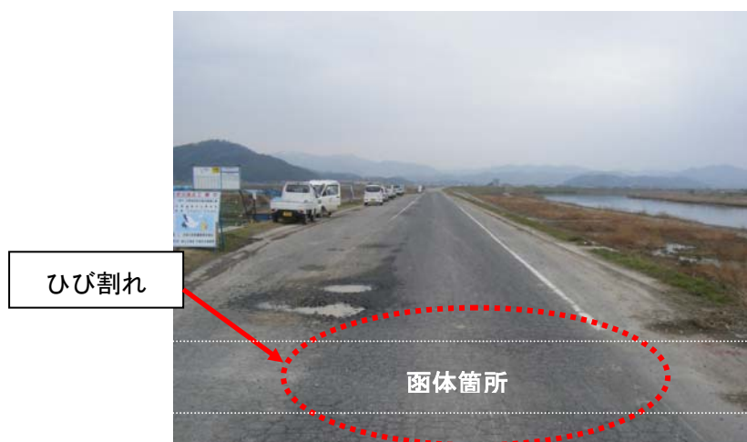
図 2.11 天端舗装のひび割れの例
