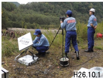
濁沢川監視カメラ設置状況
