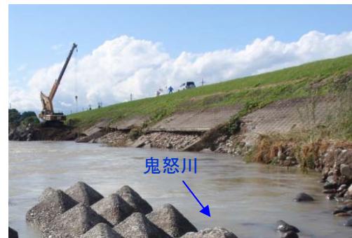
塩谷町上平地先の河岸侵食状況
