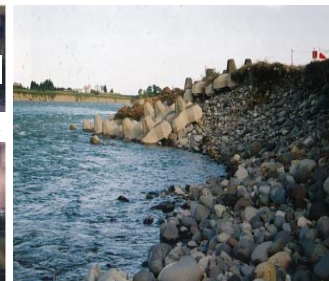
95k右岸付近の河岸侵食状況
